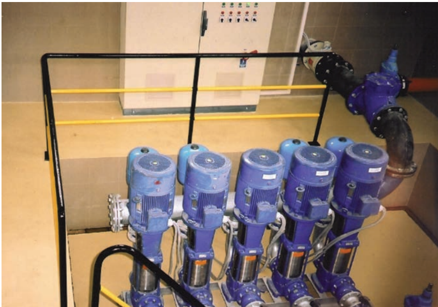
Ryc. 17. Pompownia elektryczna (fot. Łukomet)
