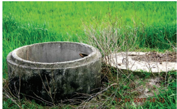
Ryc. 35. Przykład stanu studzienki drenarskiej (fot. A. Jarysz)
